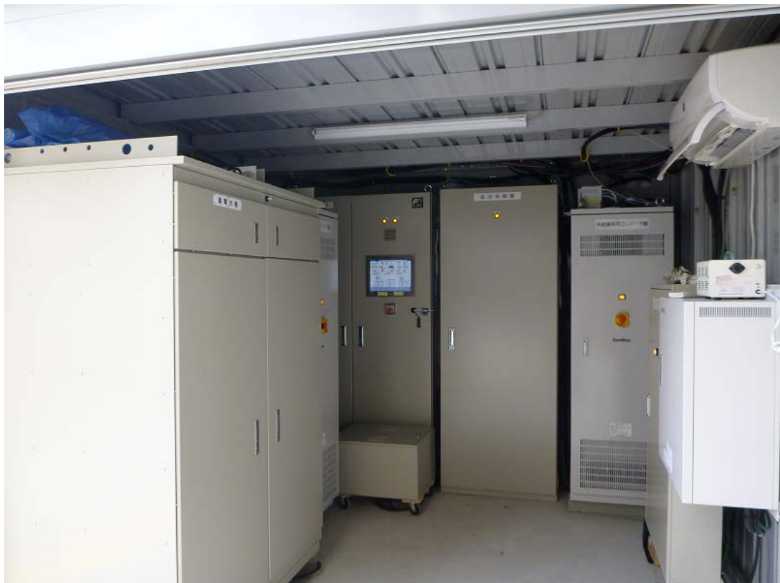
写真2 沼島総合センターに設置されているシステム
